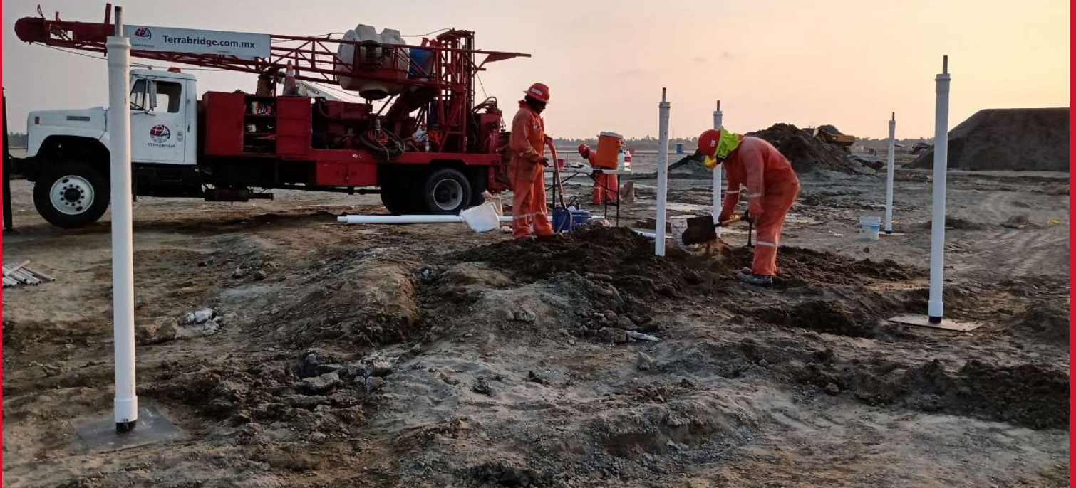
1.- NUEVA REFINERÍA 2 BOCAS, PARAÍSO, TABASCO
